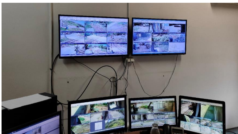
Приказ 25. Видео мониторинг во работна станица во Трубарево (Извор: Конзорциум)
